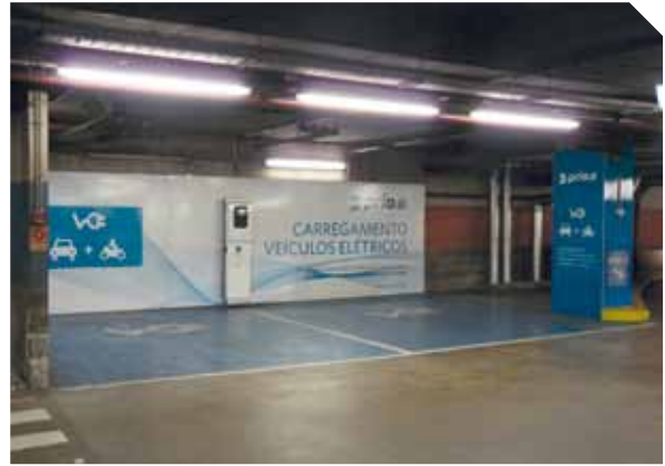
Sistema de carregamento para veículos elétricos
