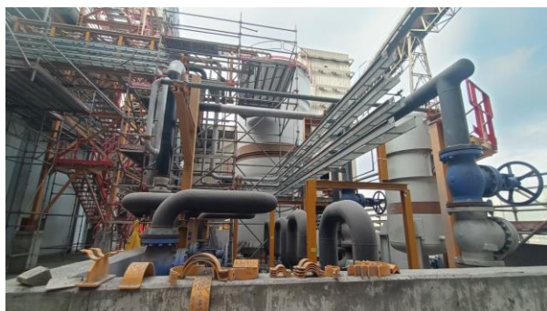
Área do depósito de óleo
